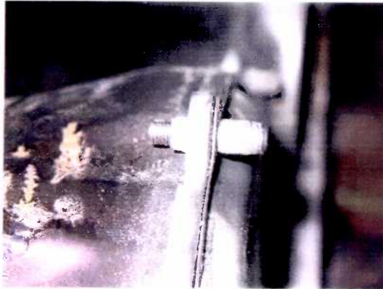
Carcasas y pernos de acople entre el compresor y la sección de accesorios
